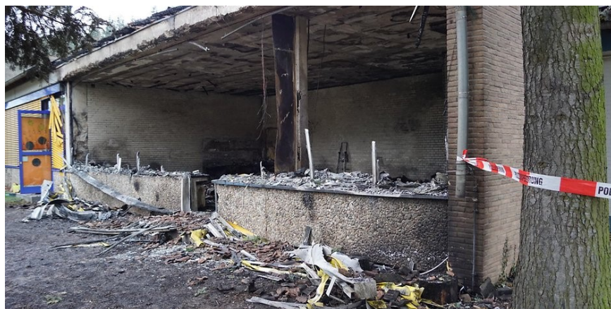
Die ausgebrannte Kita Foto: Tom Steinicke
